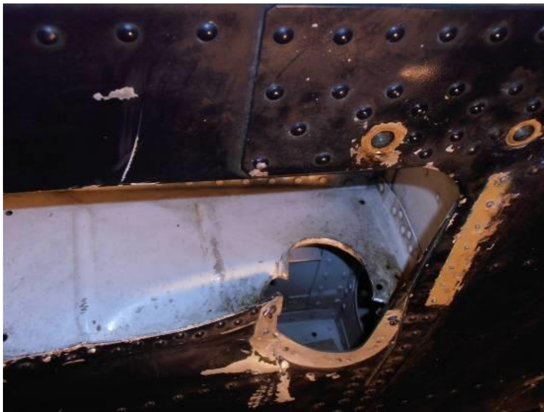
3 pav. Pažeista kairiosios sparno pusės sienelė prie pagrindinės važiuoklės atramos tvirtinimo mazgo.
