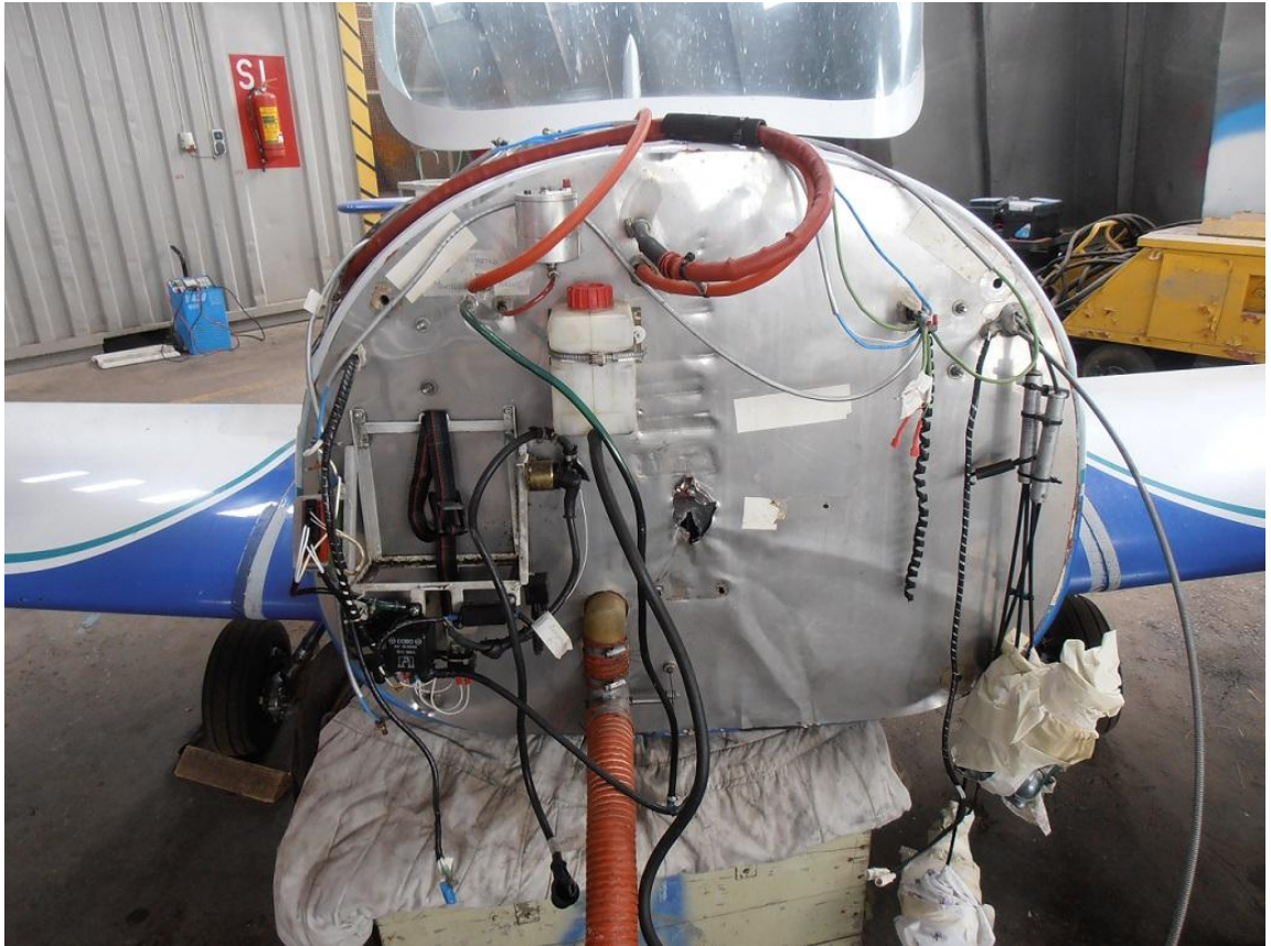
4 pav. Lėktuvo „Impulse 100“ variklio skyriaus priešgaisrinės sienelės pažeidimai.
