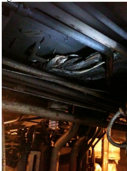
4 pav. Gaisro metu nukentėję elektros kabeliai mašinų skyriuje.
